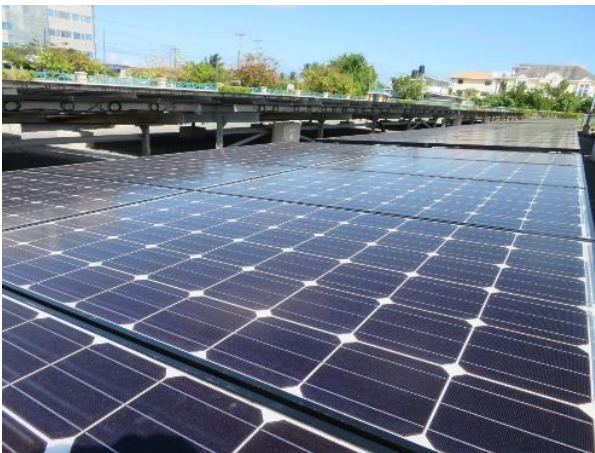
設置されたソーラーパネル
